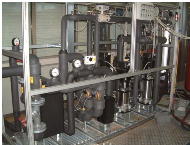
Slika 5: Merilna proga za preizkušanje regulacijskih ventilov v podjetju Danfoss, za katero je sistem vodenja razvil Odsek za sisteme in vodenje
